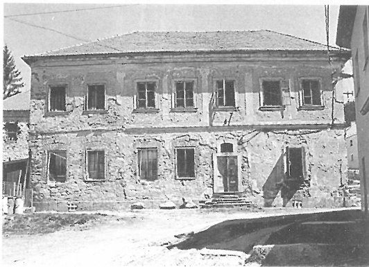
Dům New York před opravami (NPÚ)
